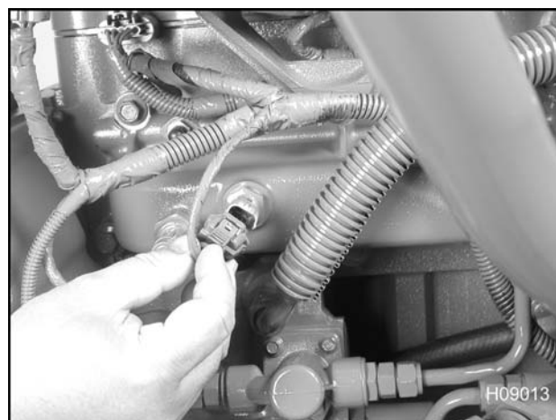
Figura 481 Conexión al MAT
